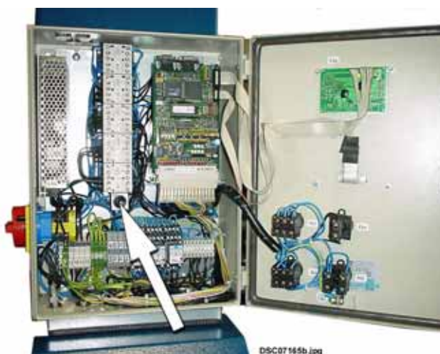
Bild 2: Position des Überbrückungsschalter
