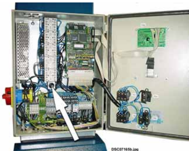
Bild 2: Position des Überbrückungsschalter
