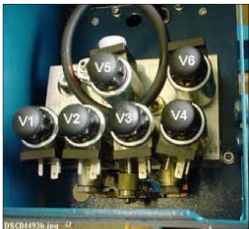
Bild 4 Ventile mit Handbetätigung für Notablass
